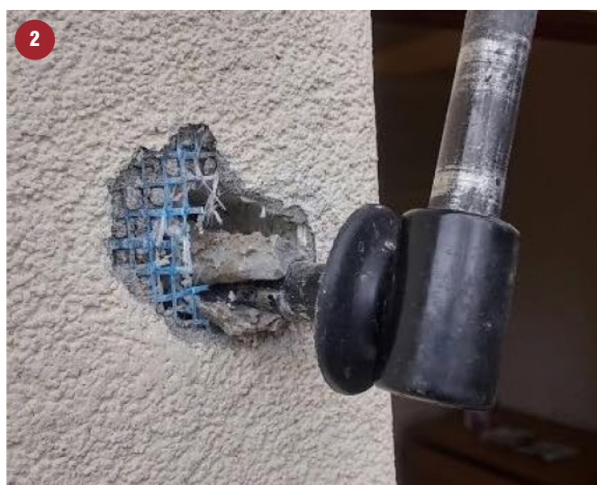
2. Cedimento del cardine, punto particolarmente soggetto a carichi dovuti alle azioni meccaniche di apertura e chiusura e a carichi degli agenti atmosferici come il vento.
