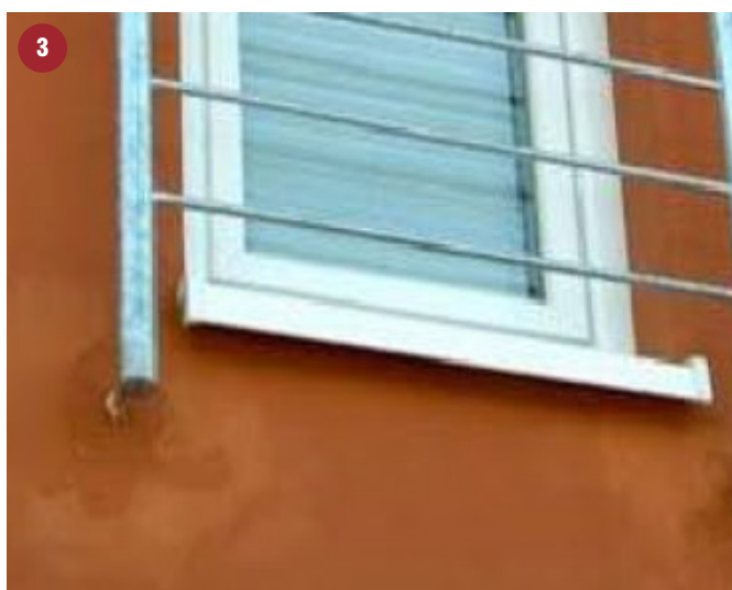
3. Infiltrazione di acqua in corrispondenza del punto di ancoraggio non opportunamente sigillato.
